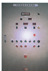
定量排出装置 自動制御盤
